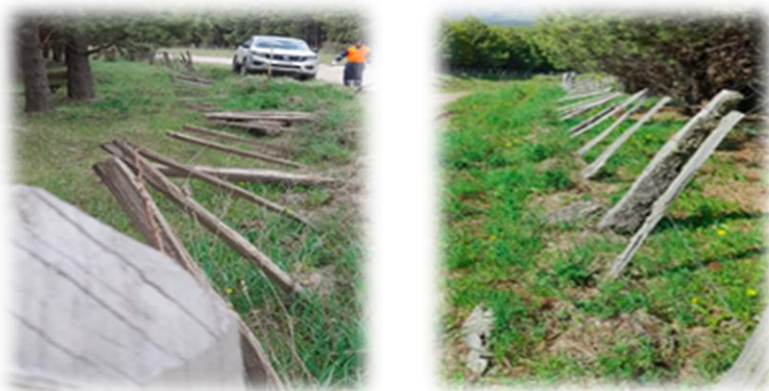
Figura 1. Estado del cerco predio La Cascada.
